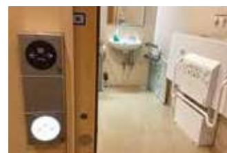
多目的トイレ 自動扉開閉装置
