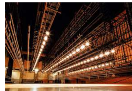
舞台機構(照明ブリッジ・バトン)
