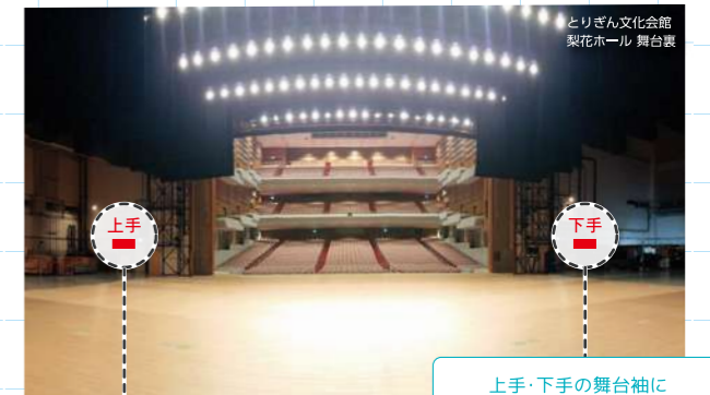
上手・下手の舞台袖にそれぞれ設置してある散水コックを手動で開きます
